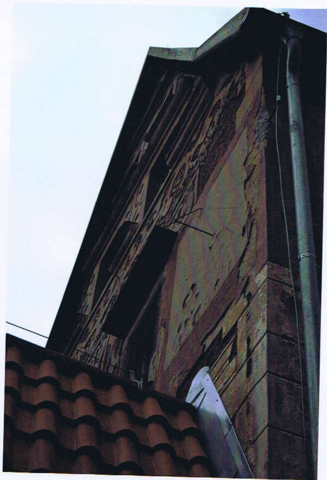
Fot. 18. Budynek bramny na zamku Grodno – fragment elewacji. Widoczne znaczne ubytki tynków, odspajających się płatami od powierzchni murów
