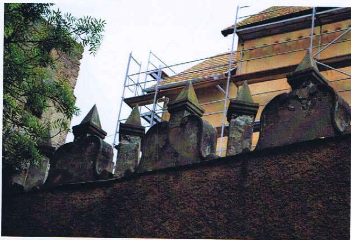
Fot. 11. Budynek bramny na zamku Grodno – fragment murów obwodowych przylegających do budynku. Widoczny zły stan zachowania tynków, związany z brakiem izolacji górnych powierzchni murów
