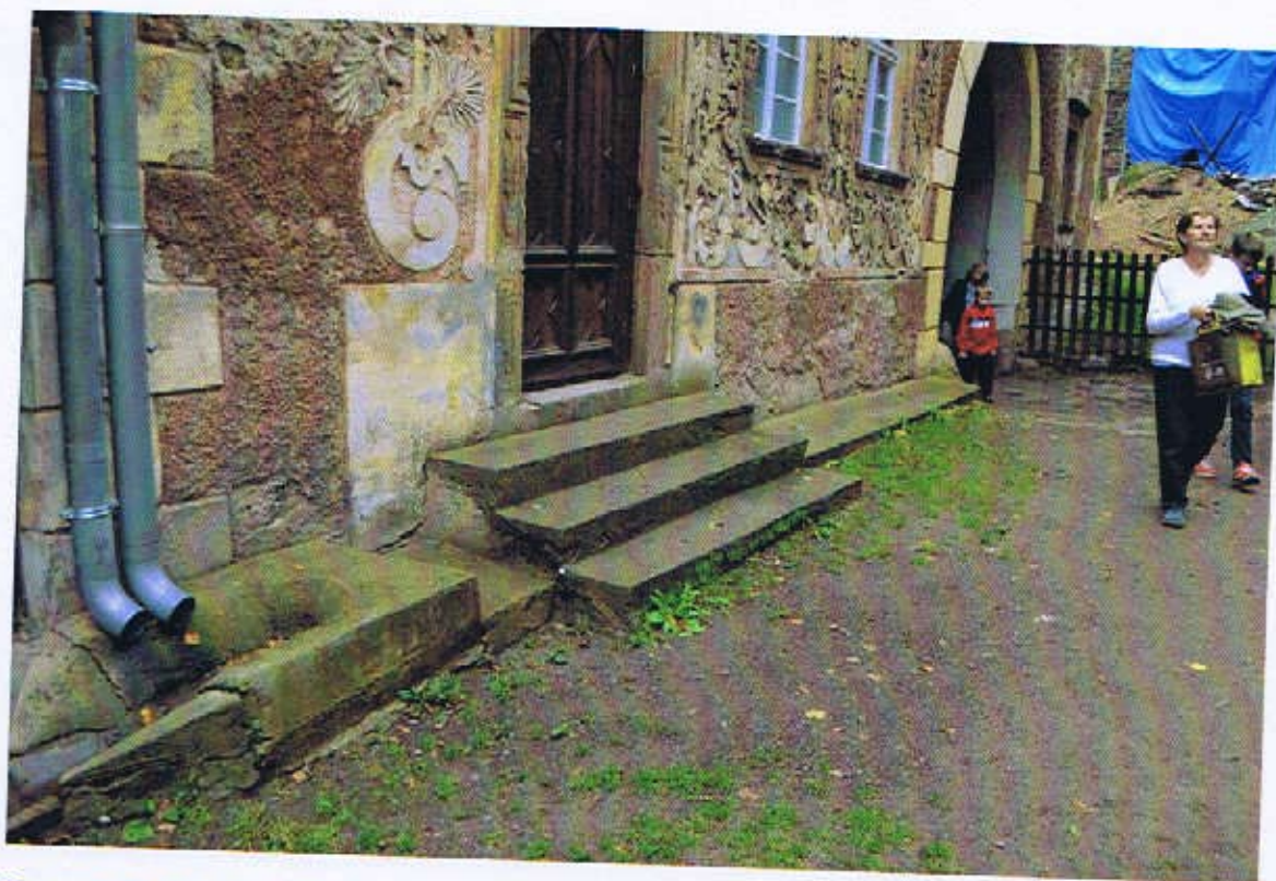
Fot. 19. Budynek bramny na zamku Grodno – fragment elewacji. Widoczne opaski cementowe przyczyniające się do stałego zawilgacania i zasilania murów
