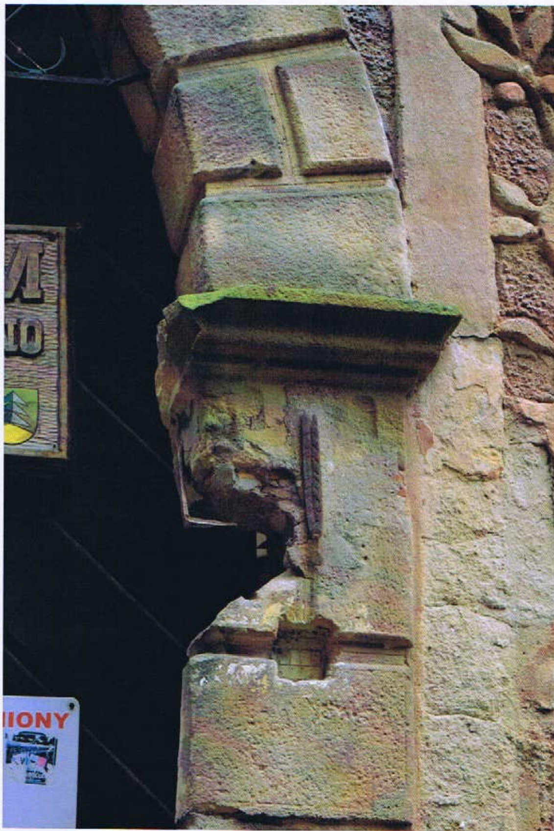
Fot. 10. Budynek bramny na zamku Grodno – fragment elewacji frontowej. Widoczne ubytki kamienia związane ze zmianą stolarki drzwiowej.
