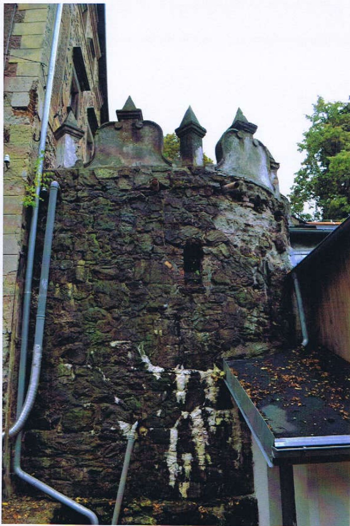
Fot. 6. Budynek bramny na zamku Grodno – fragment murów obwodowych, przylegających do budynku. Widoczne wykwyty solne
