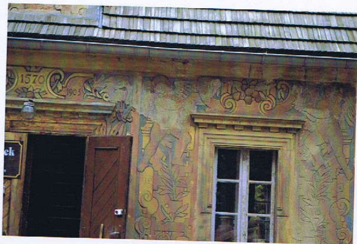
Fot. 20. Budynek bramny na zamku Grodno – fragment elewacji j. Widoczny zły stan zachowania tynków, wypłukanych przez strumienie wody opadowej
