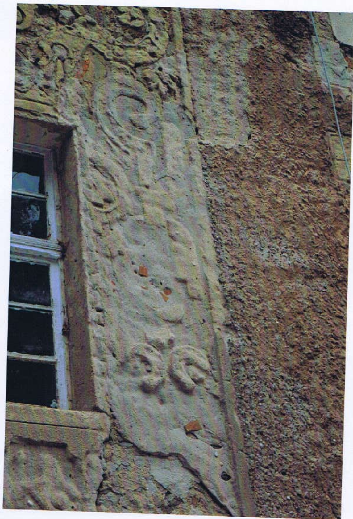
Fot. 5. Budynek bramny na zamku Grodno – fragment elewacji frontowej. Widoczny zły stan zachowania tynków, wypłukanych przez strumienie wody opadowej
