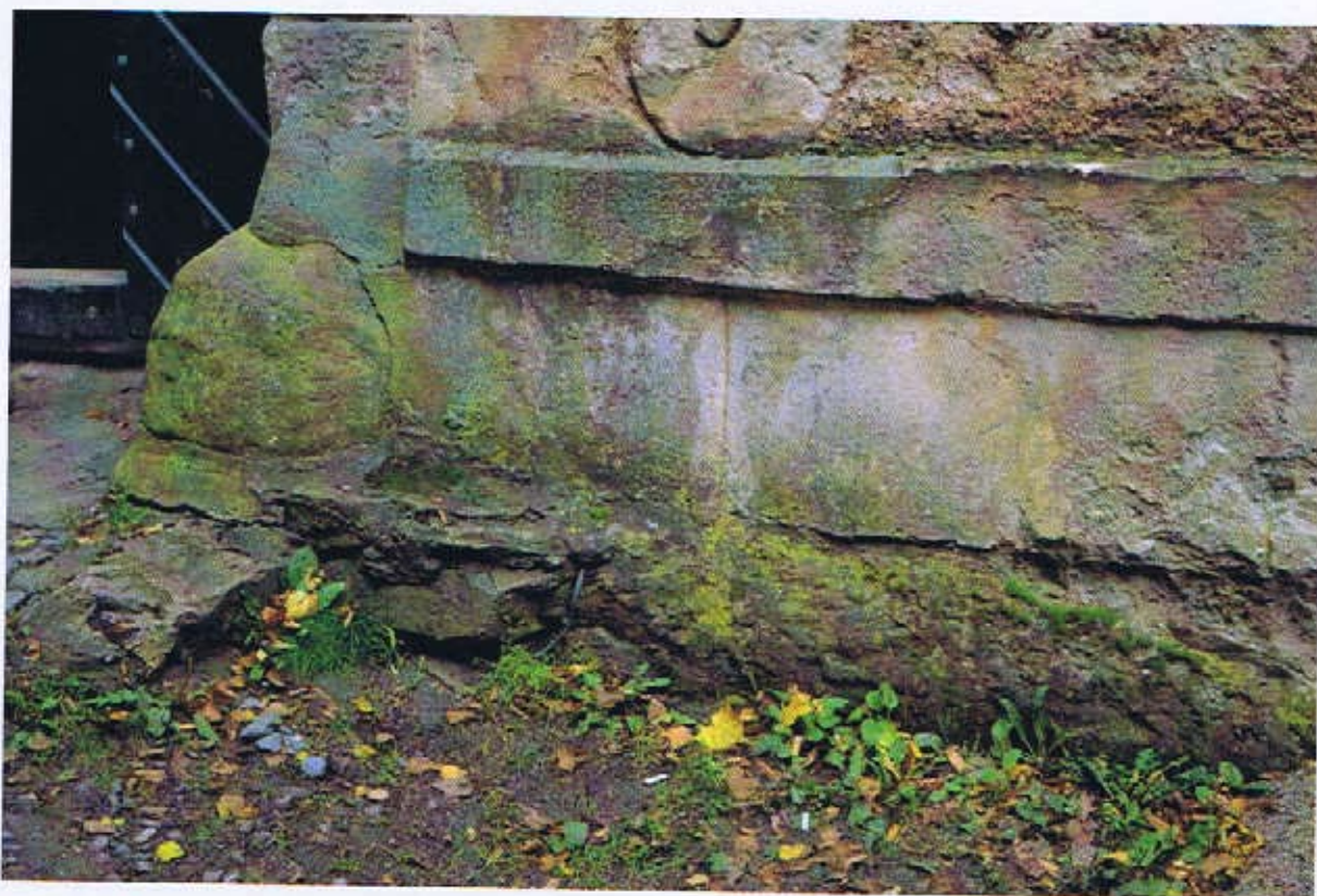
Fot. 8. Budynek bramny na zamku Grodno – fragment partii przyziemia elewacji frontowej. Widoczne zły stan zachowania murów związany z brakiem izolacji fundamentów
