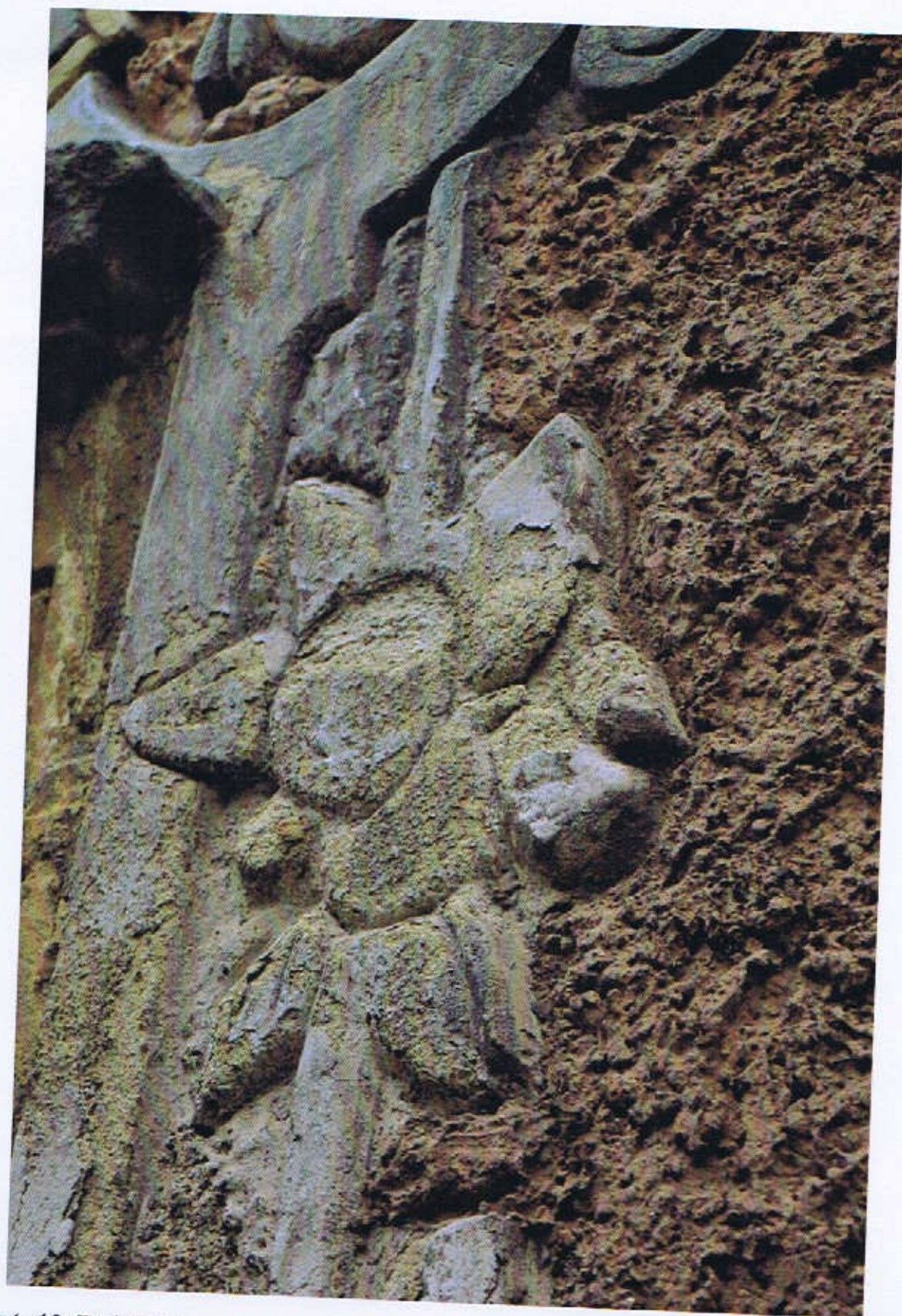
Fot. 16. Budynek bramny na zamku Grodno – fragment elewacji. Widoczne ubytki oraz złuszczenia polichromii
