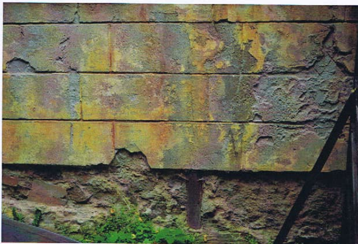
Fot. 4. Budynek bramny na zamku Grodno – brak izolacji fundamentów oraz silne zawilgocenie murów doprowadziło do odspajania się dużych połaci tynków w partii przyziemia
