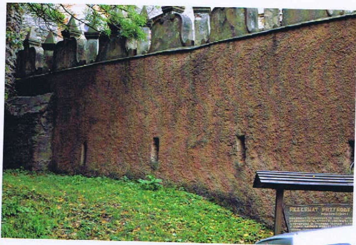
Fot. 9. Budynek bramny na zamku Grodno – fragment murów obwodowych przylegających do budynku. Widoczne zaplamienia wywołane działalnością mikroorganizmów w zawilgoconym podłożu
