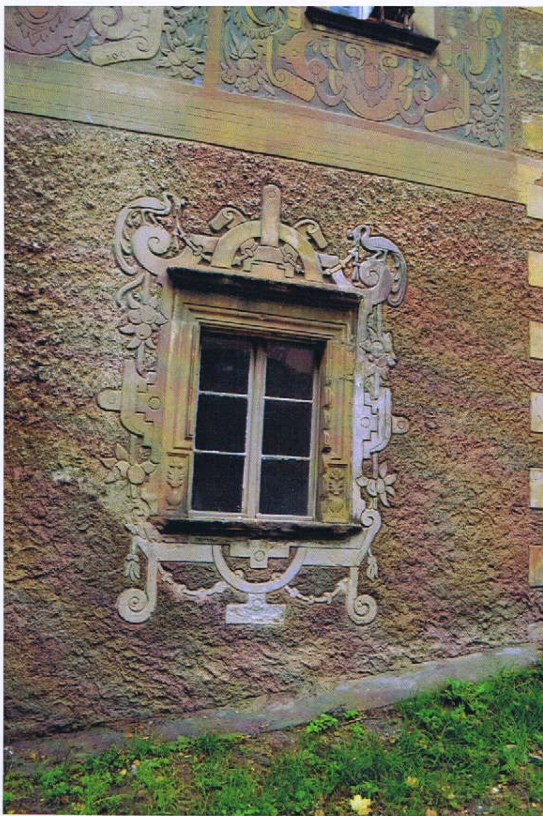
Fot. 14. Budynek bramny na zamku Grodno – fragment elewacji. Widoczne ciemne zaplamienia tynków wywołane silnym ich zawilgoceniem oraz działalnością mikroorganizmów
