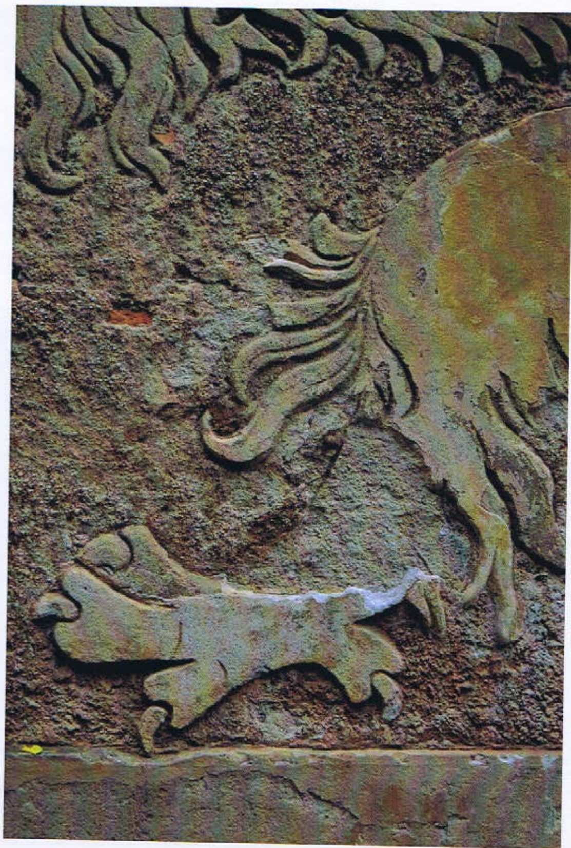
Fot. 2. Budynek bramny na zamku Grodno – fragment elewacji frontowej. Widoczny zły stan zachowania tynków, spowodowany wypłukaniem spoiwa oraz działalnością mikroorganizmów w strukturze ściany.
