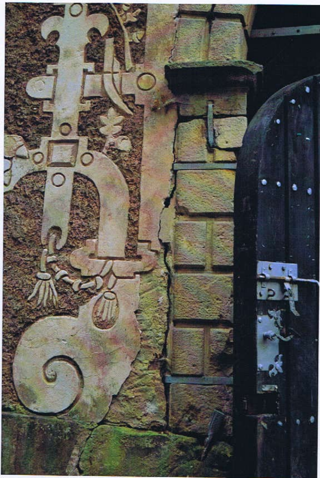
Fot. 3. Budynek bramny na zamku Grodno – fragment portalu wjazdu bramnego na elewacji frontowej. Widoczne spękania konstrukcyjne muru
