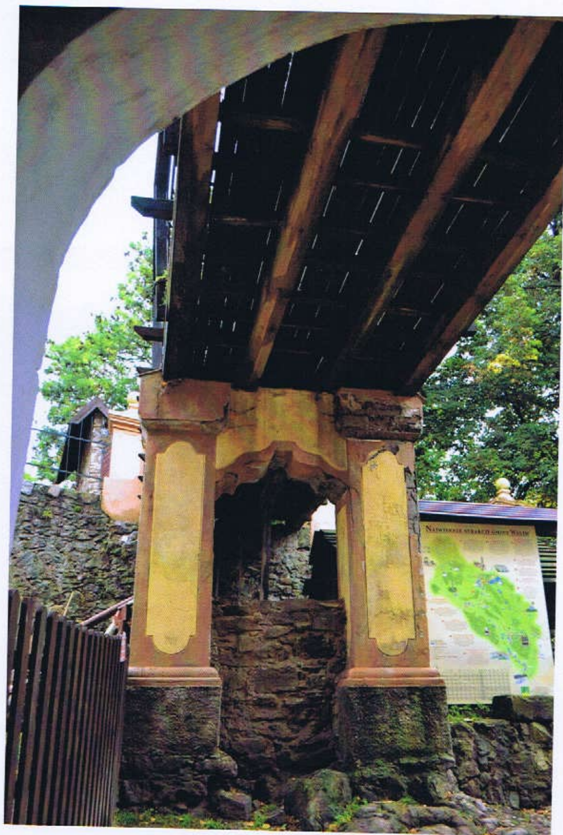
Fot. 12. Budynek bramny na zamku Grodno – pomost prowadzący na pierwsze piętro budynku. Widoczny zły stan zachowania tynków oraz silne zawilgocenie struktury murów.
